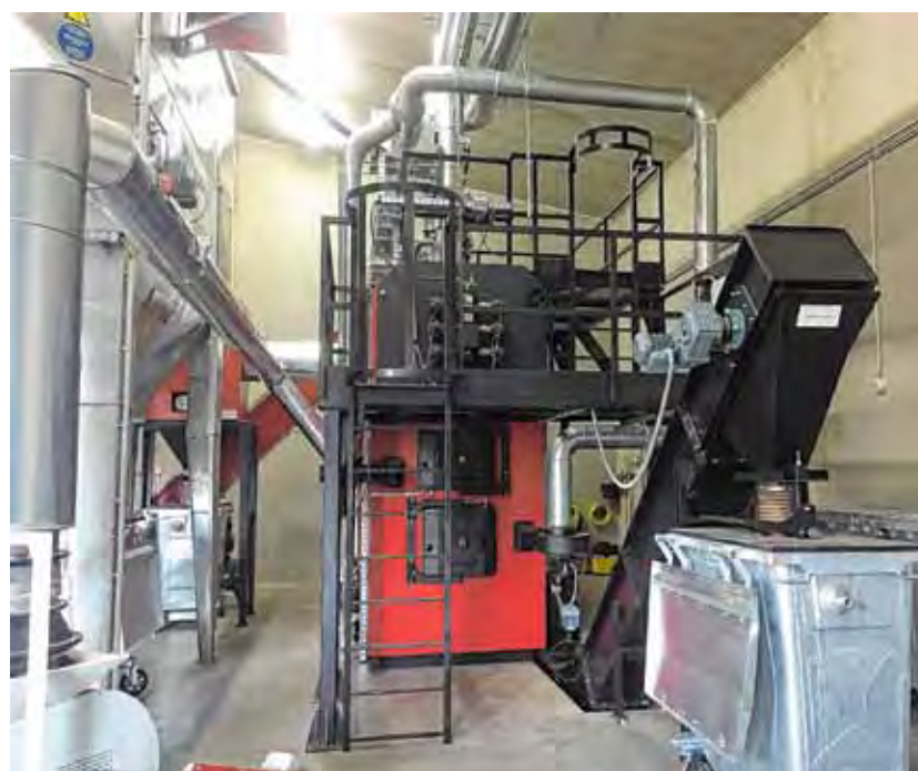
Biomassefeuerung, E-Filter und Ascheaustragung
