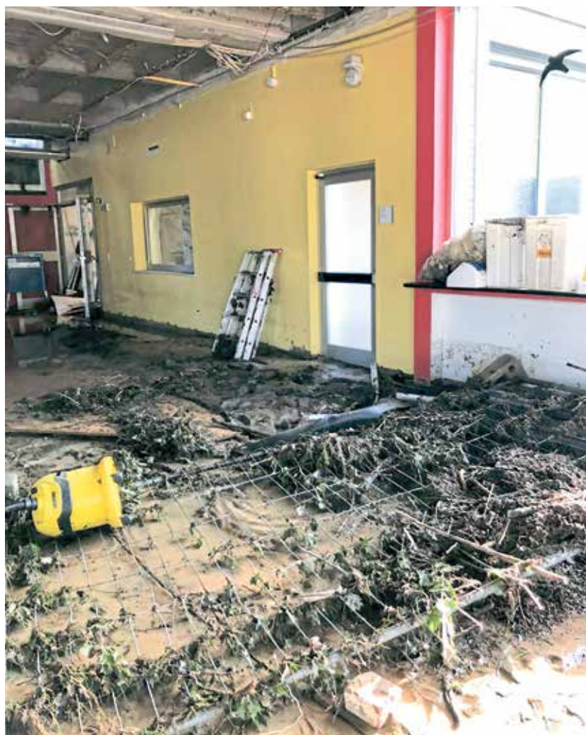
Beim Unwetter vor einem Jahr wurden in der Gemeinde Herrstein auch viele Häuser und Wohnungen von den Wassermassen geradezu verwüstet.
